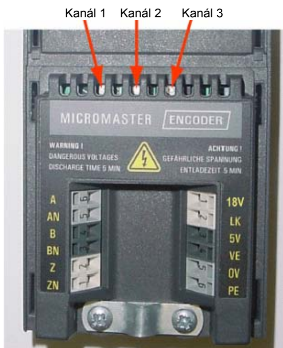
Obrázek 2-4 LED diody pro indikaci provozního stavu
